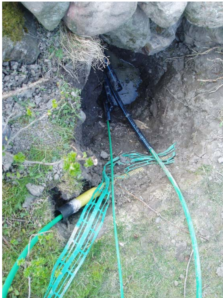
Bild 41. Korsar stenmur vid kopplings skåp nere vid vägen 4:19
