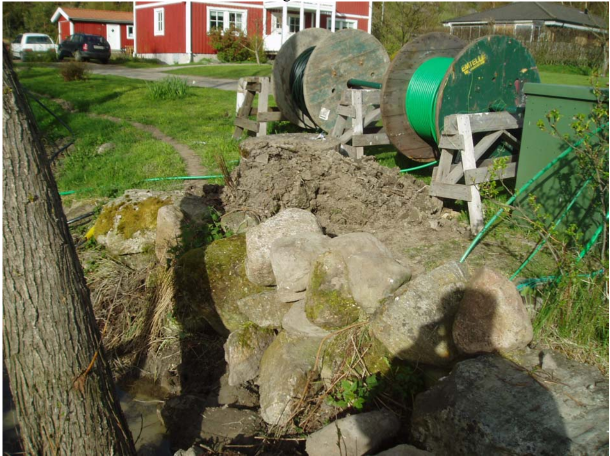
Bild 40. Kopplings skåp nere vid vägen 4:19 schakt syns på bild in mot 4:19.
